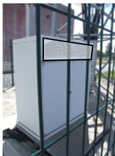
armoire contenant les cartes de communication, à proximité de l'antenne GSM
