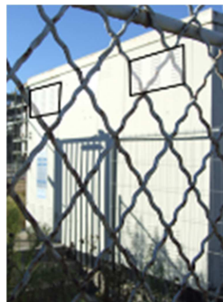
transformateur BT-HTA « cellule de vie »
