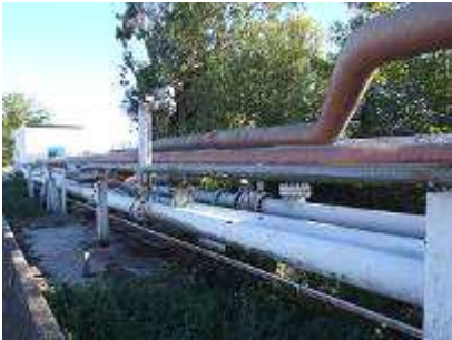
canalisations SPBA et VERMILION
