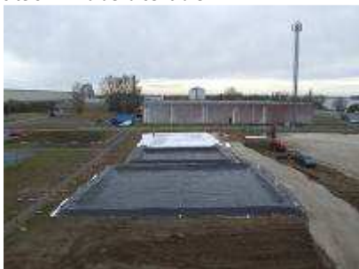
site EDF FIRE vu de la centrale
